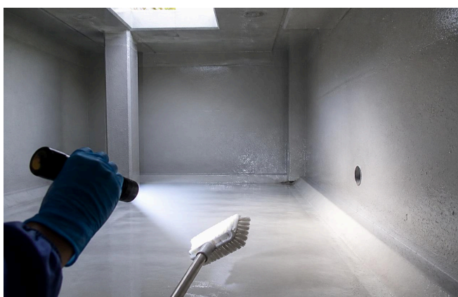
Interior de reservatório predial após a higienização, em inspeção de superfícies — imagem ilustrativa.
